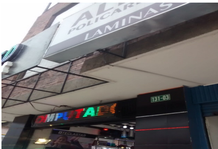
Fotografía No. 2: Aviso volado/saliente de fachada del establecimiento Alpha Policarbonato, Ubicado en la Calle 131 No. 45 – 12
